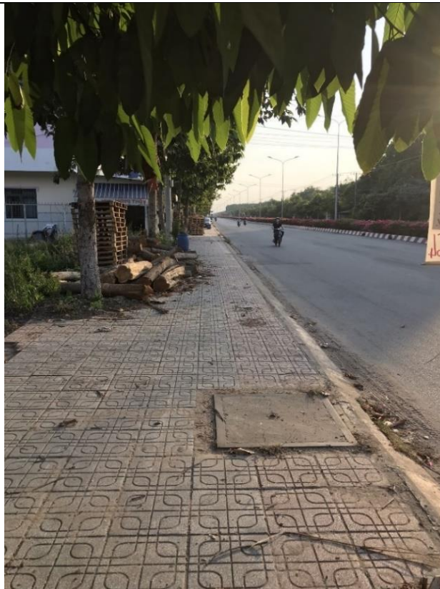
Hình 8: Hiện trạng cống thoát nước trên đường Chính ĐT.08 (ĐH.606/Lộ 7A)
